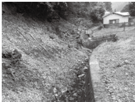
土砂崩れ対策工事を待つ佐山川
