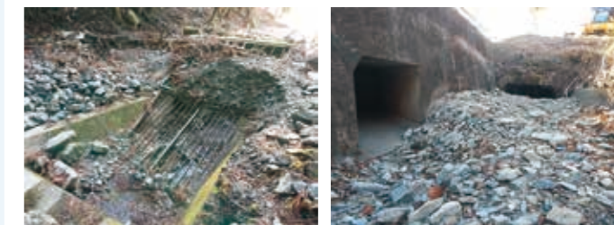
既存流木・土砂止め工(スクリーン)に堆積した土砂(東部西)
