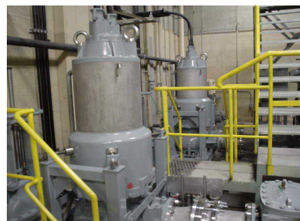
更新された嬉石ポンプ場の主ポンプ
